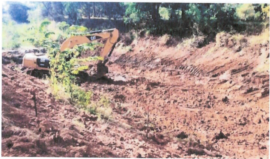
ภาพที่ 6 แสดงการ CLEARING พื้นที่ก่อสร้าง
